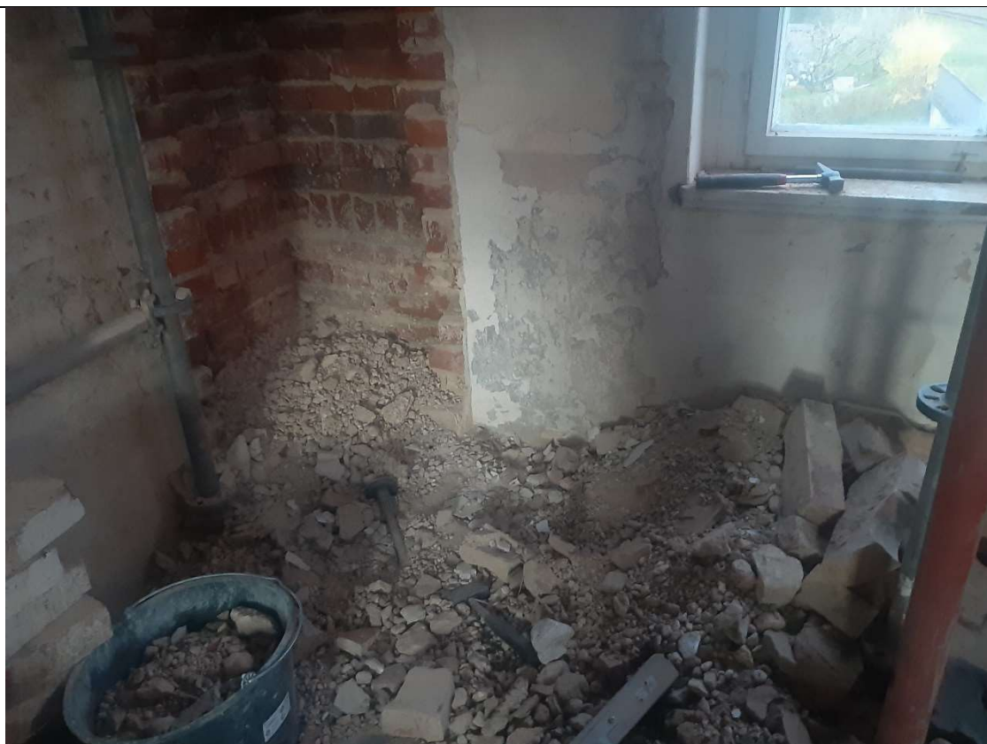
Im Stellwerk hingegen „bröseln“ zunächst Putz und Mauerwerk. (AT)
