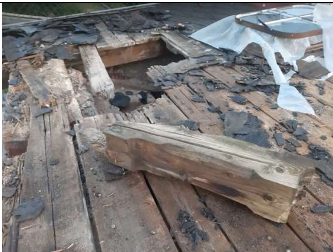
Hier wird deutlich, wie sehr der Zahn der Zeit hat am Dach des Stellwerks nagte... (AT)
